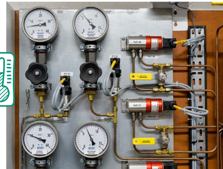
Manometers die de druk in het primaire en secundaire net aangeven.
